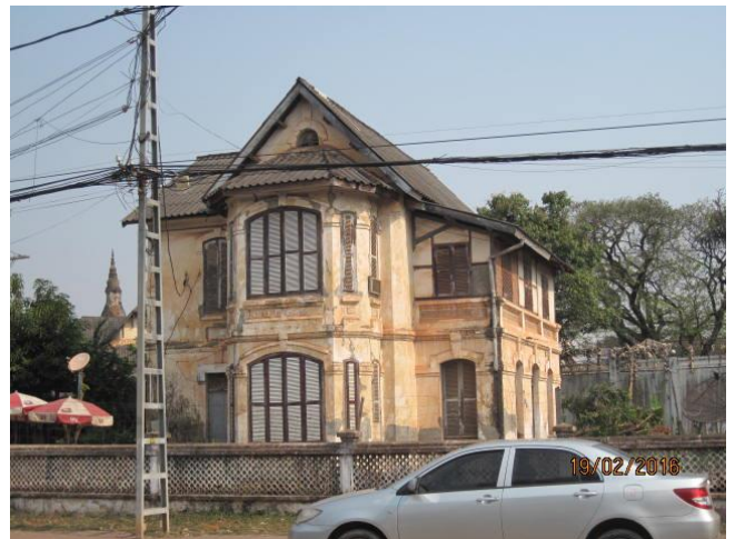
放置状態で外壁がかなり傷んでいる
